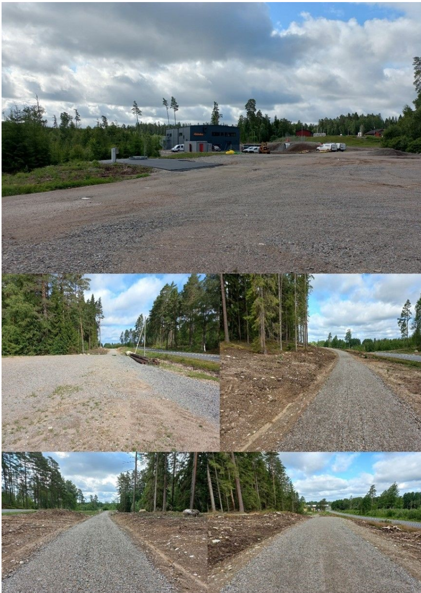
Figur 17: Övre bild visar nya studielokalen och pumpanläggningen för VA-ledningar. Nedre bild visar förberedelse för en ny gång- och cykelvägen utmed Stockarydsvägen till studielokalen och motorbanan.
